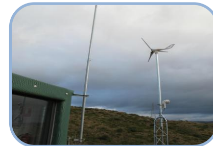
Sistema de energía eólica
