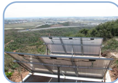
Sistema de energía solar
